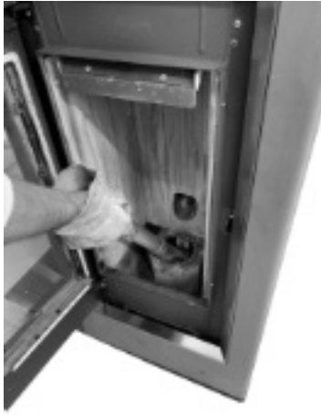
Fig. 36 - Rengöring av brännkoppfacket
