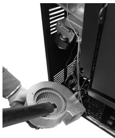
Fig. 71 - Rengöring av rumsfläkt
