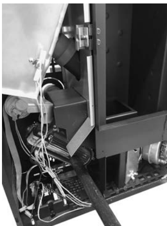
Fig. 69 - Rengöring av rumsfläkt
