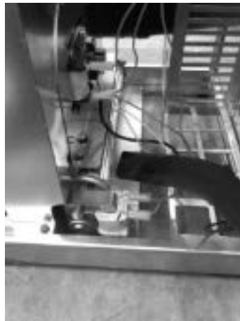
Fig. 74 - Rengöring av rumsfläkt
