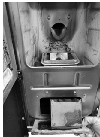
Fig. 73 - Ta bort inspektionslocket
